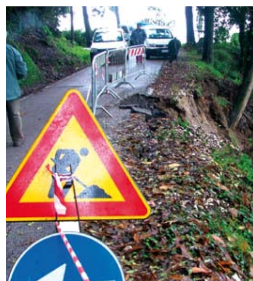
Cedimento della scarpata lungo la strada del Cimitero di Gavorrano
